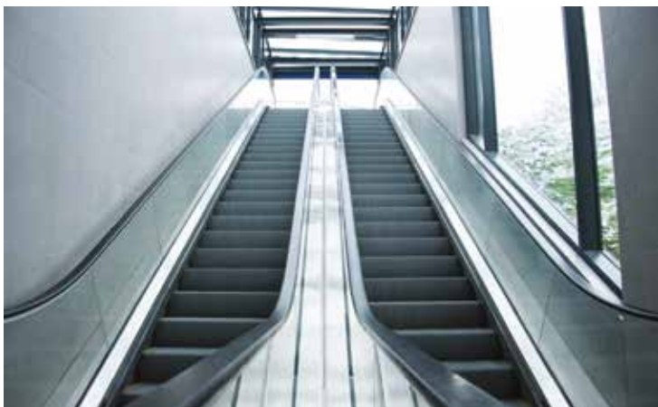
Schody ruchome przy stacji metra Służew
